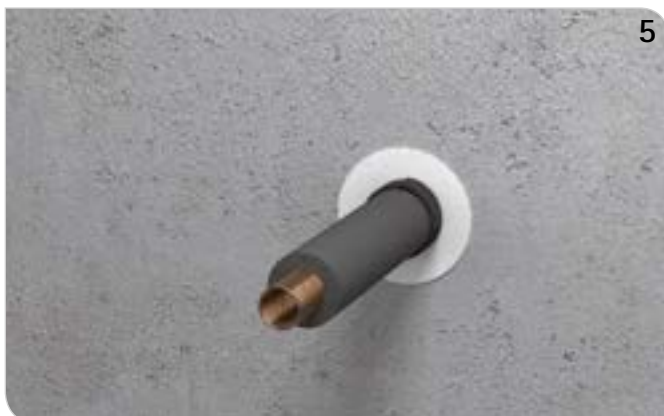
Ggf. Kontrolle der Abschottung.
