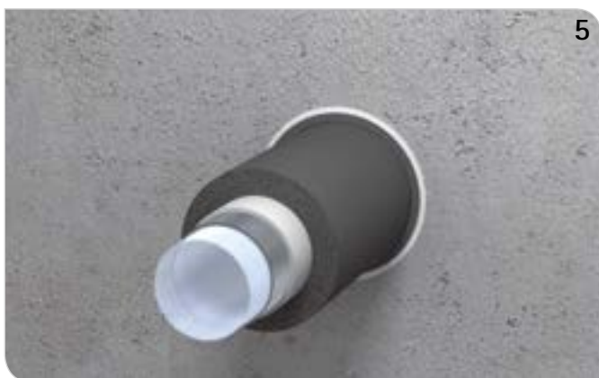
Ggf. Kontrolle der Abschottung.
